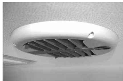
Elektrischer Be- und Entlüfter
