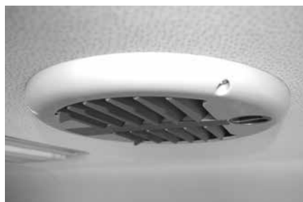
Elektrischer Be- und Entlüfter
