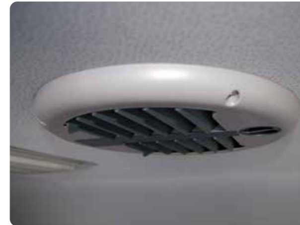
Aération et ventilation
